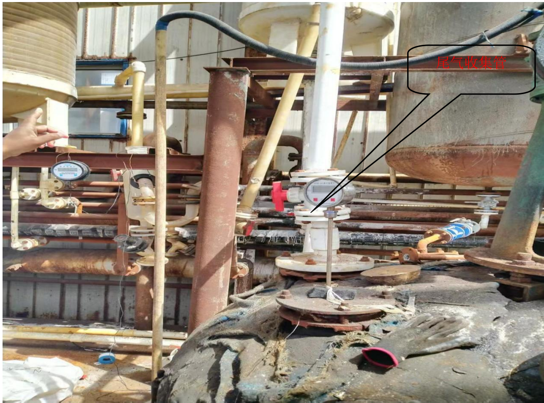
图五 尾气收集管道
