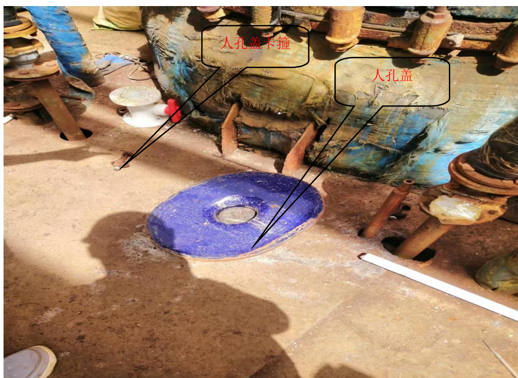
图三 掉落在操作平台上的反应釜人孔盖和人孔卡箍
