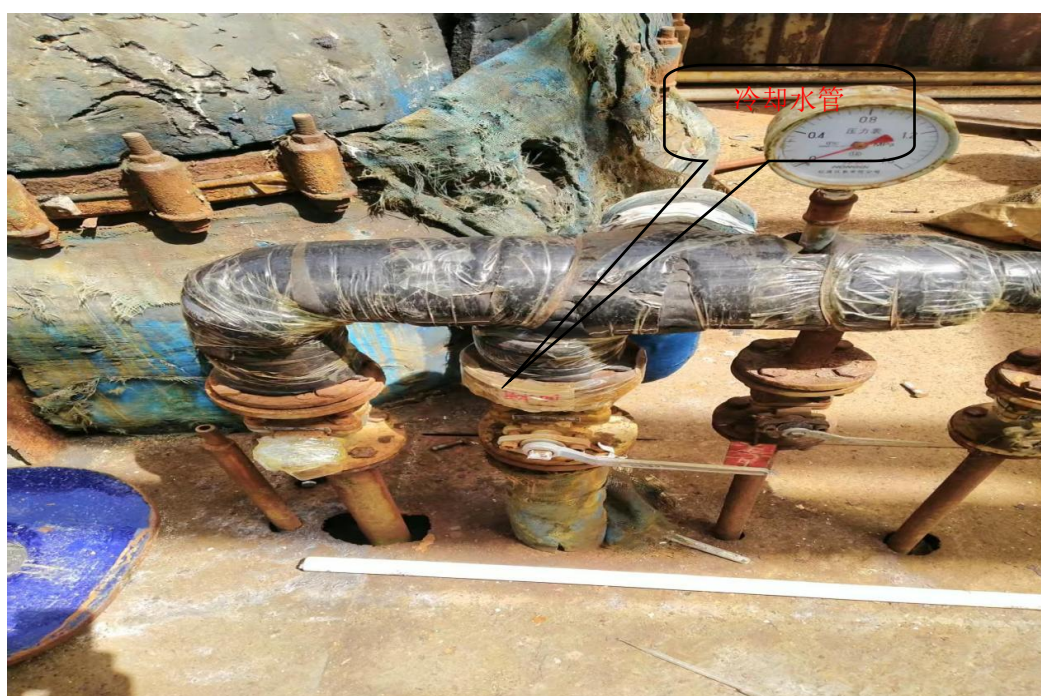
图四 反应釜冷却水管道
