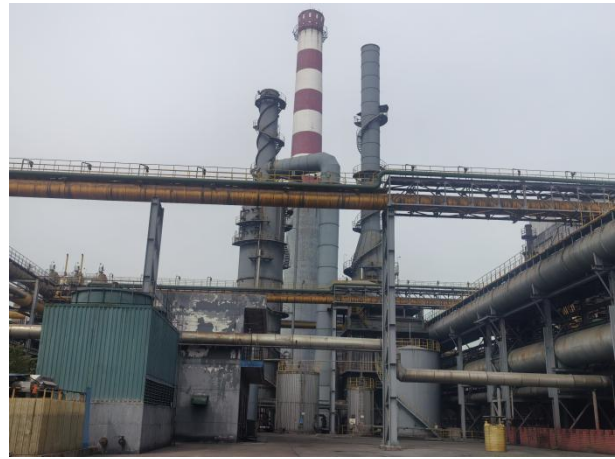
焦炉废气治理设施
