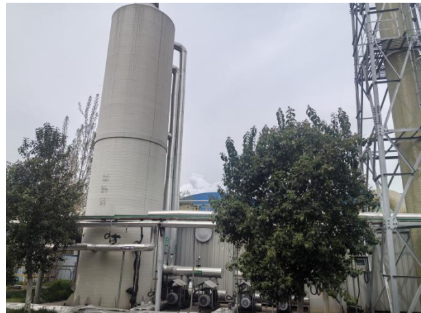
厂区污水处理除臭碱洗塔装置
